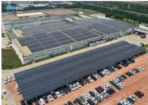
大連アルプスの太陽光発電設備
